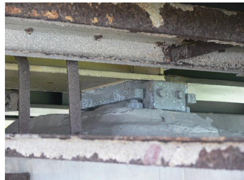
腐食事例：橋梁の桁内部の腐食
